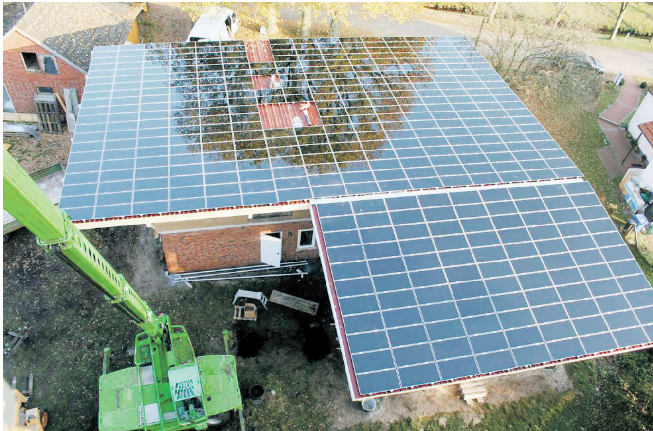
In Tüschendorf hat Karl-Heinz Busch ein Einfamilienhaus mit einer beeindruckenden Photovoltaikanlage ausgestattet.
